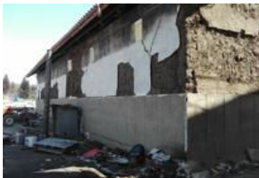
（崩壊した旧式の倉庫）
